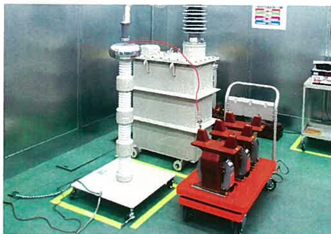
シールドルーム Shield room
