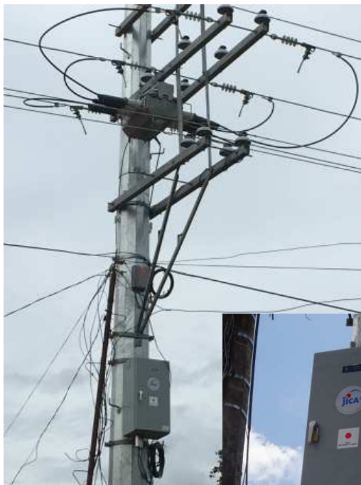
装柱された開閉器と制御器
