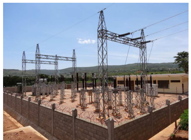
第1次PJ Rwinkwavu 変電所の外観
