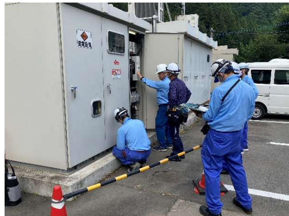
(受電盤操作訓練)
