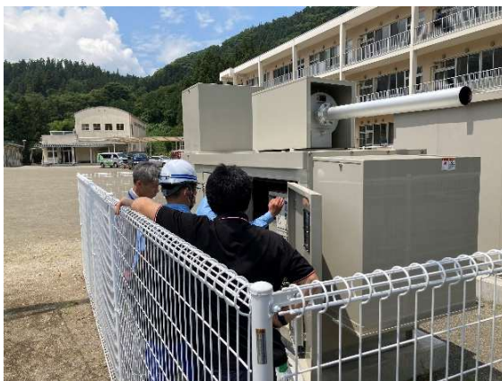
(非常用発電機操作訓練)
