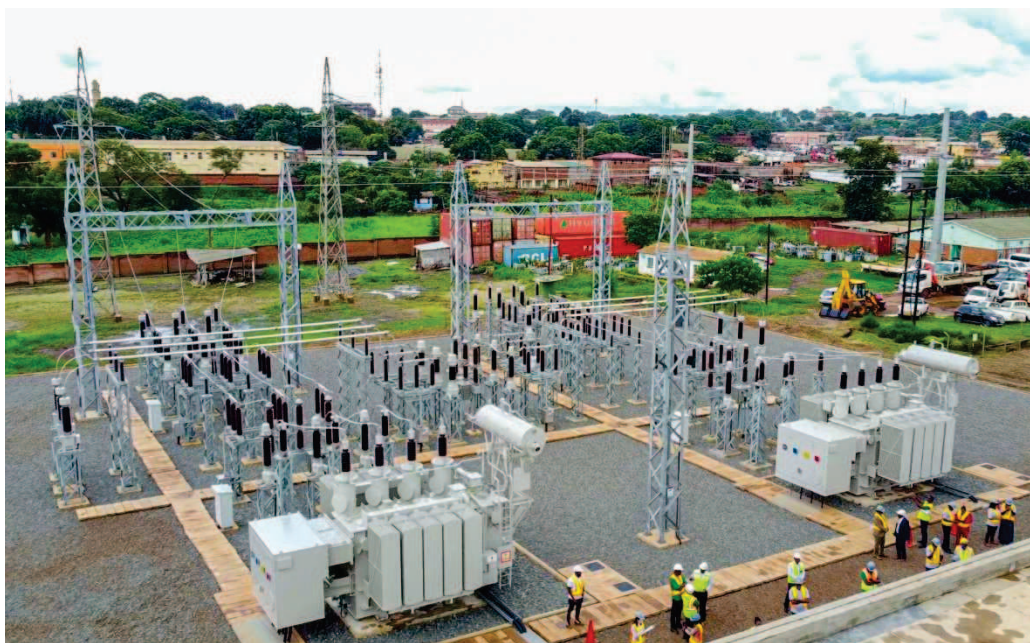
オールドタウン変電所（2024年3月1日竣工）
