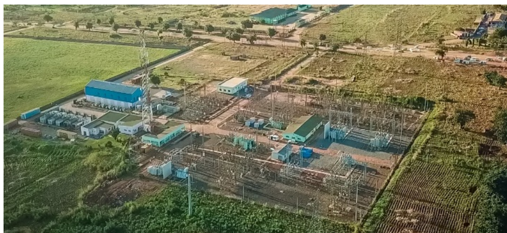
カネンゴ変電所（2024年5月2日竣工）
