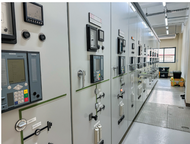
図 4 33 kV GIS（外観）
