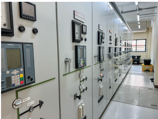
図 4 33 kV GIS（外観）
