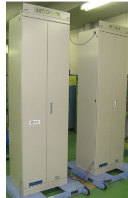
装置外観（左：ロジック架，右：端子架）
