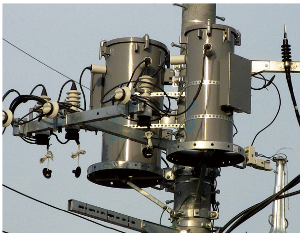
図 12 オートタップチェンジャー付柱上変圧器
