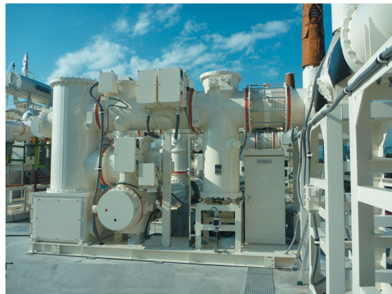
図4 168 kV 縮小形 GIS 変圧器直結
