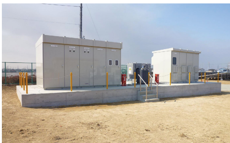
系統連系盤／昇圧変圧器／パワーコンディショナー
