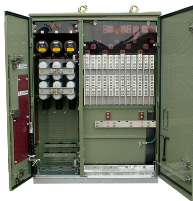
図11 地上用変圧器
