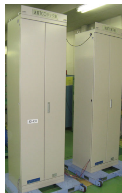
装置外観（左：ロジック架、右：端子架）
