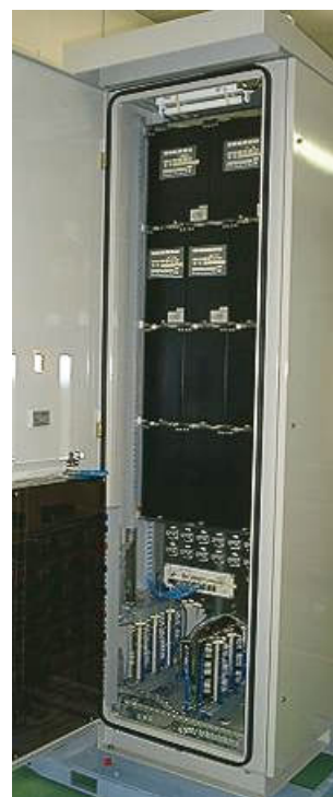
図9 配電用変電所デジタル保護制御装置（バンク制御盤）
