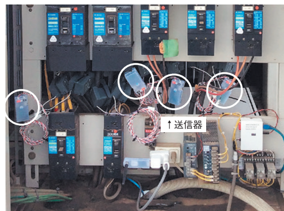
図 5 現場取付状況 送信器
