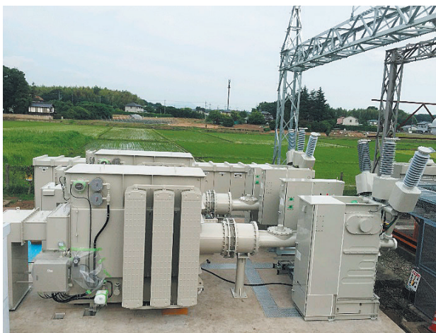
図 2 新設備の外観
