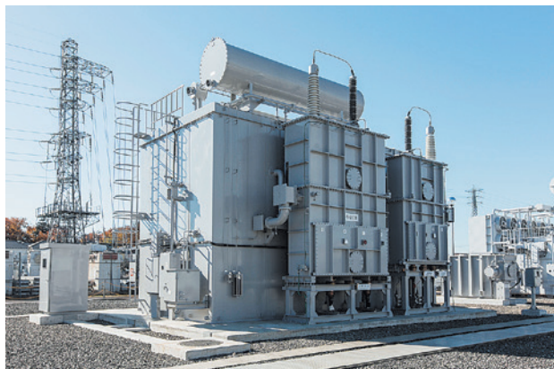
図 1 154 kV 200 MVA 変圧器外観
