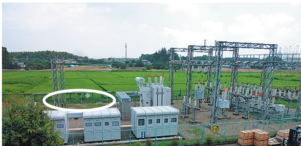
図 1 現設備の外観
