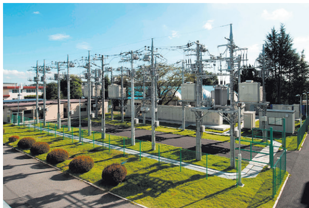
図2 配電ネットワーク実証試験場
