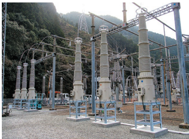
図 1 220 kV 自立形ガス EVT の設置状況
