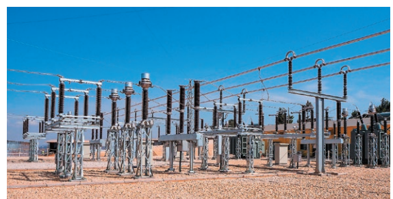
図 3 造成した敷地に設置された変電設備
