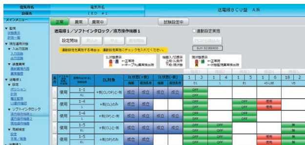
図 7 変電所機器のソフトインタロック設定画面
