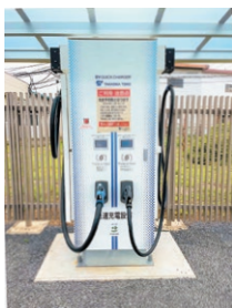
図 1 本器設置状況
