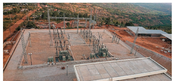
図 2 図 1 の A 点から撮影した新ガソギ変電所 （敷地の急傾斜がうかがえる）
