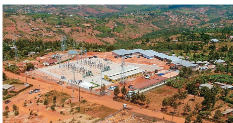
図 5 式典当日の新ガソギ変電所の遠景
