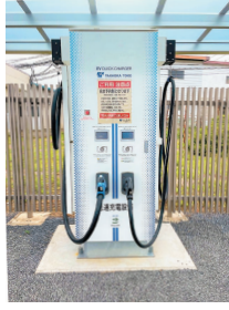
図 1 本器設置状況
