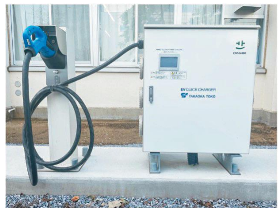
図3 15kW 中容量急速充電器（自立設置）
