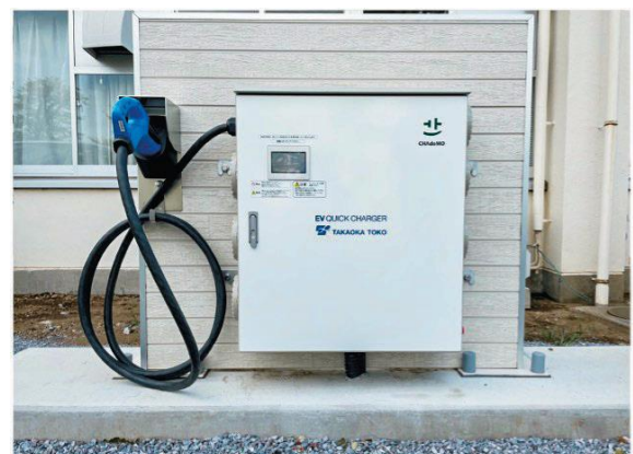
図4 15kW 中容量急速充電器（壁掛け設置）
