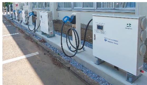
図 4 新たに設置した 15 kW モデル中容量急速充電器（手前）と普通充電器、普通充電コンセント（奥）
