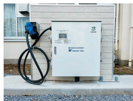
図 6 15 kW モデル中容量急速充電器 壁掛け設置の例
