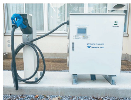
図 5 15 kW モデル中容量急速充電器 自立設置の例
