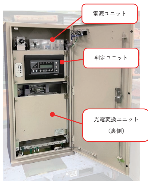
(b) 正面扉を開けた状態
