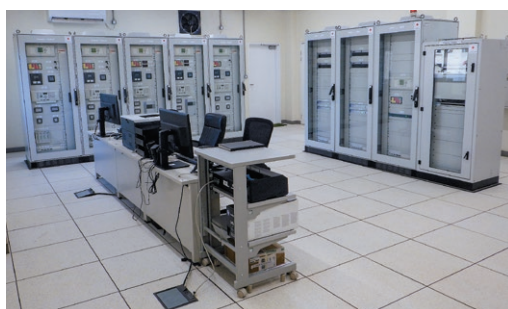
図 4 変電所自動監視制御保護装置
