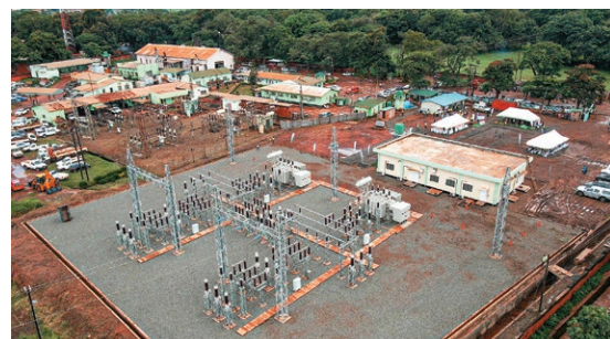
図3 オールドタウン変電所（左上が既設変電所）
