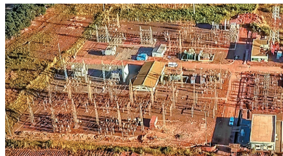
図2 カネンゴ変電所（右下が新設した制御室）
