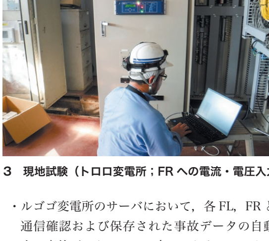
図3 現地試験（トロロ変電所；FR への電流・電圧入力）
