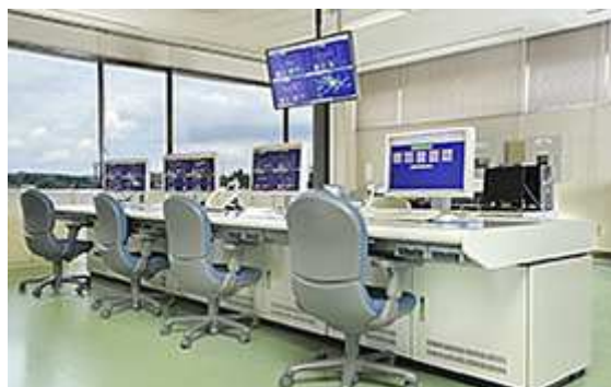
<水処理監視制御システム>
