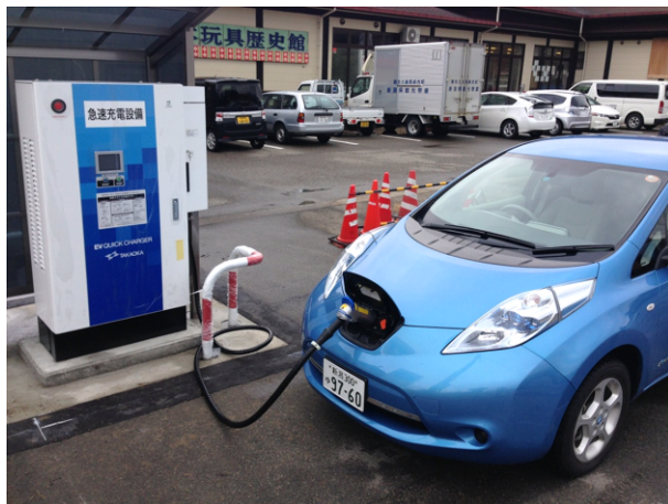
＜観光地に設置された電気自動車用急速充電器＞
