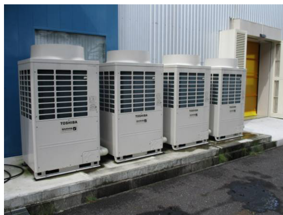
＜蓮田地区に導入した高効率空調機＞
