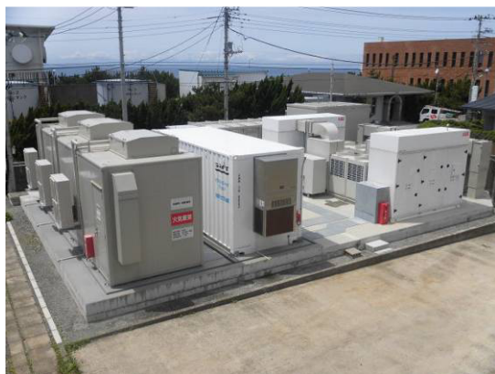
＜新島電気所内に設置された蓄電設備＞
