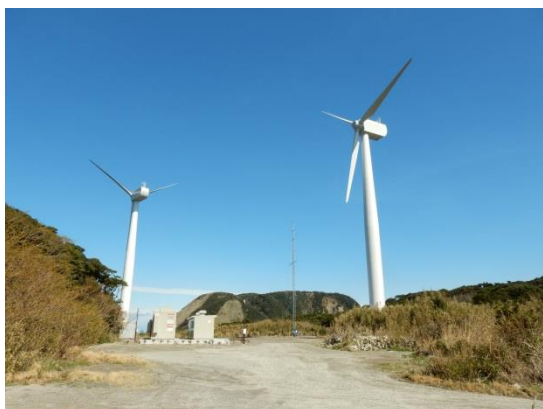
<東京都新島村に設置された風力発電設備>
